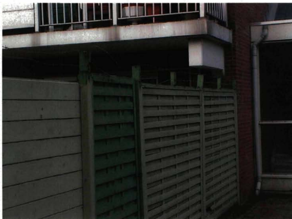
Maatregelen op schutting om overklimming tegen te gaan.
