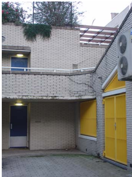
Scheuren en vochtproblemen
