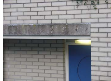
Betonijzer aan oppervlak
